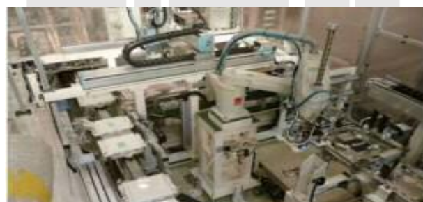
《リチウムイオン電池モジュール組立設備》
